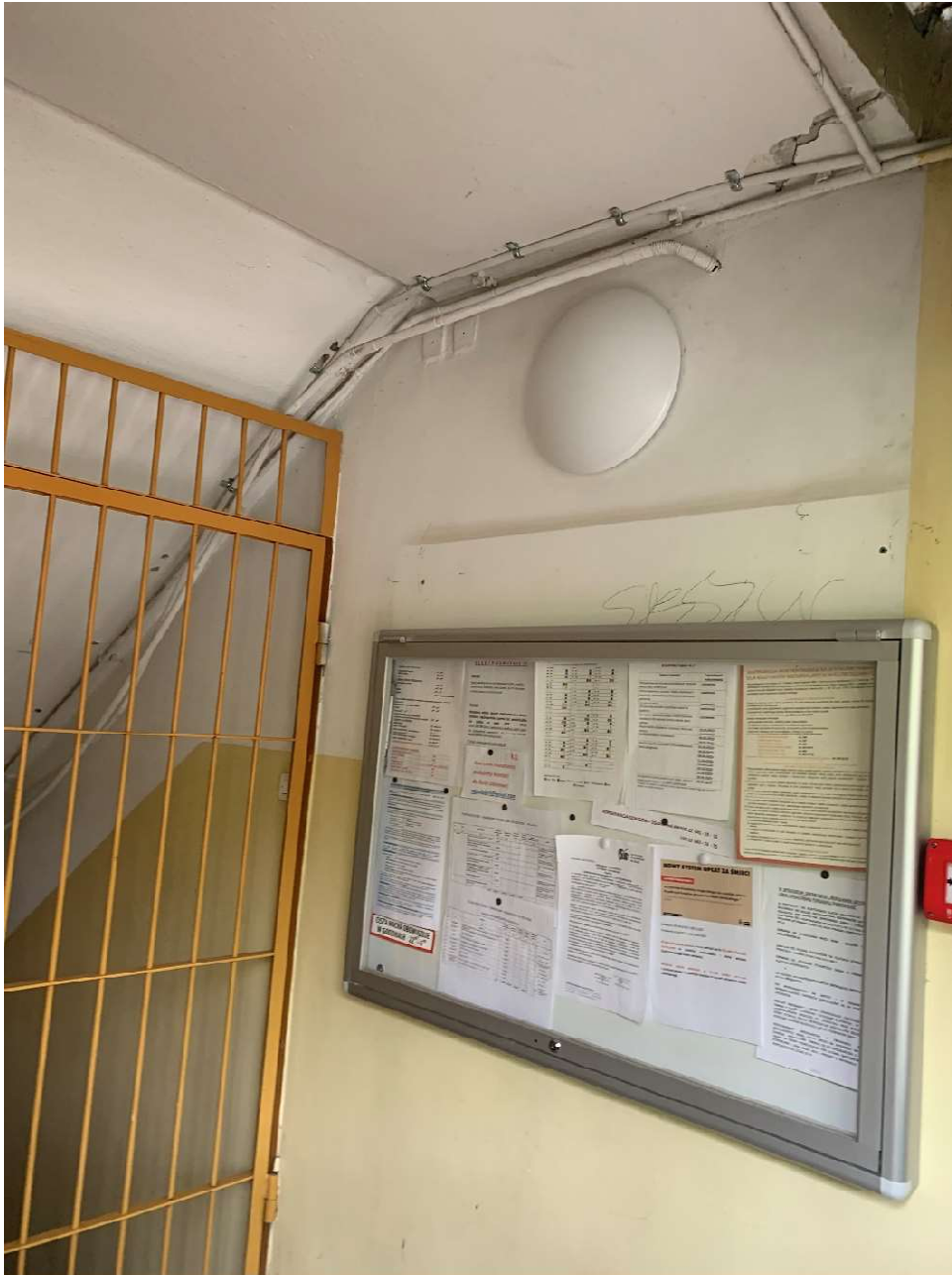
Zdjęcie nr 2 – widok na ścianę między klatką schodową a pomieszczeniem byłego zsypu na śmieci (klatka 2)
