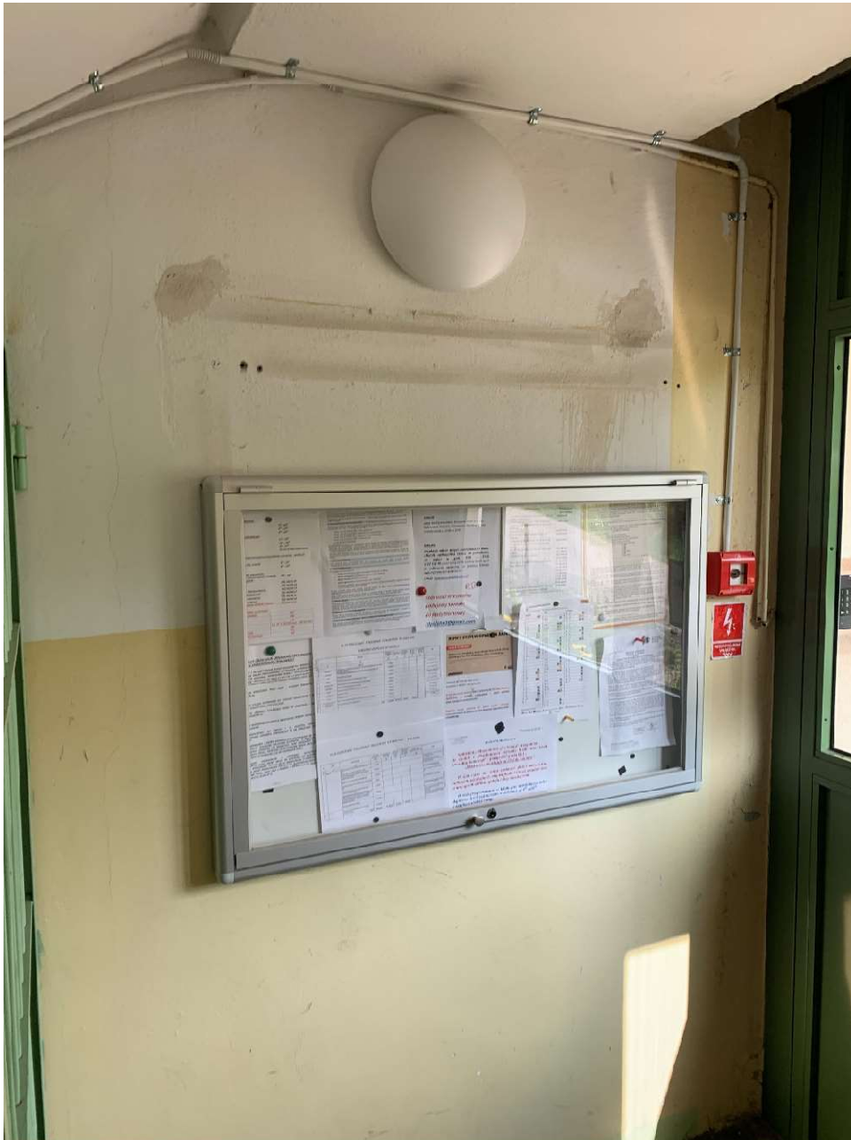
Zdjęcie nr 1 – widok na ścianę między klatką schodową a pomieszczeniem byłego zsypu na śmieci (klatka 4)
