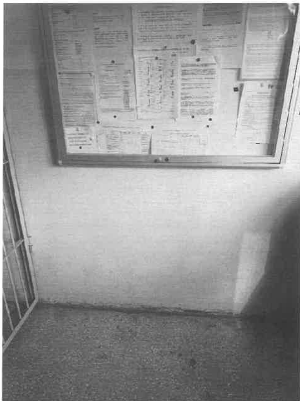
Zdjęcie nr 5 – widoczna strefa wejściowa (prawa strona) na klatkę schodową z oparzeniami i ubytkami lamperii (klatka 3).
