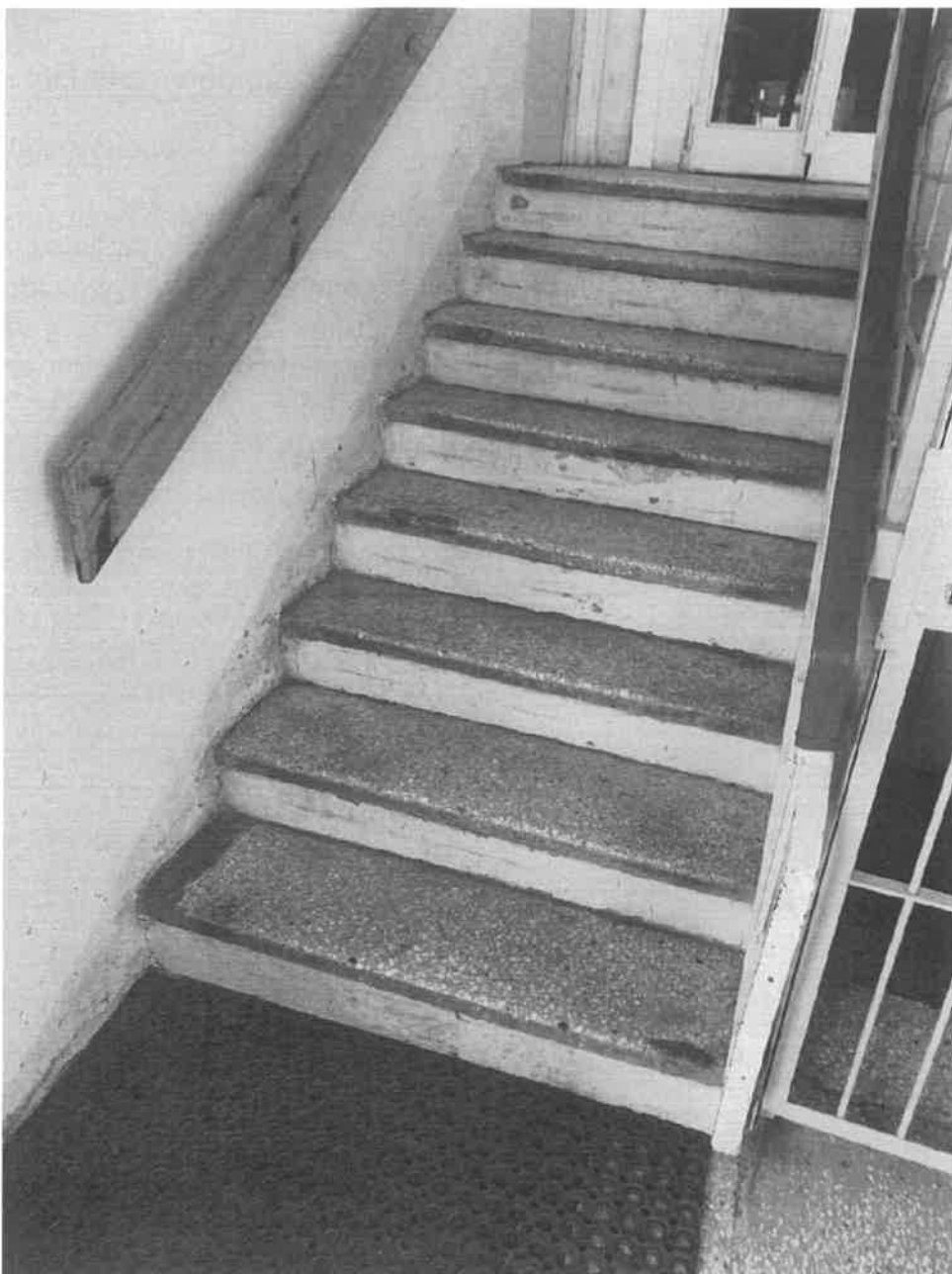
Zdjęcie nr 4 – widoczna strefa wejściowa (lewa strona) na klatkę schodową z oparzeniami i ubytkami lamperii (klatka 3).
