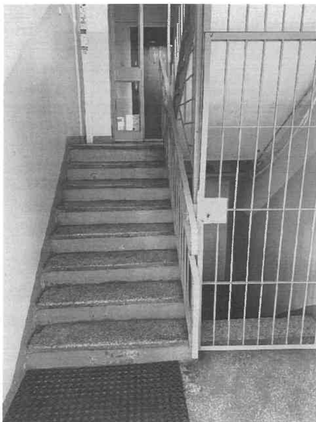
Zdjęcie nr 6 – widoczna strefa wejściowa (lewa strona) na klatkę schodową z oparzeniami i ubytkami lamperii (klatka 2).
